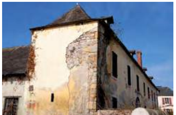
Enduit dégradé laissant apparaître le chaînage d'angle et la composition du mur. Préchacq-Navarrenx.
