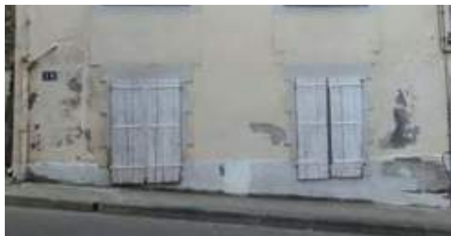
Traces d'humidité sur un mur ancien enduit au ciment. L'eau stockée dans le mur ne parvient pas à s'évacuer.
