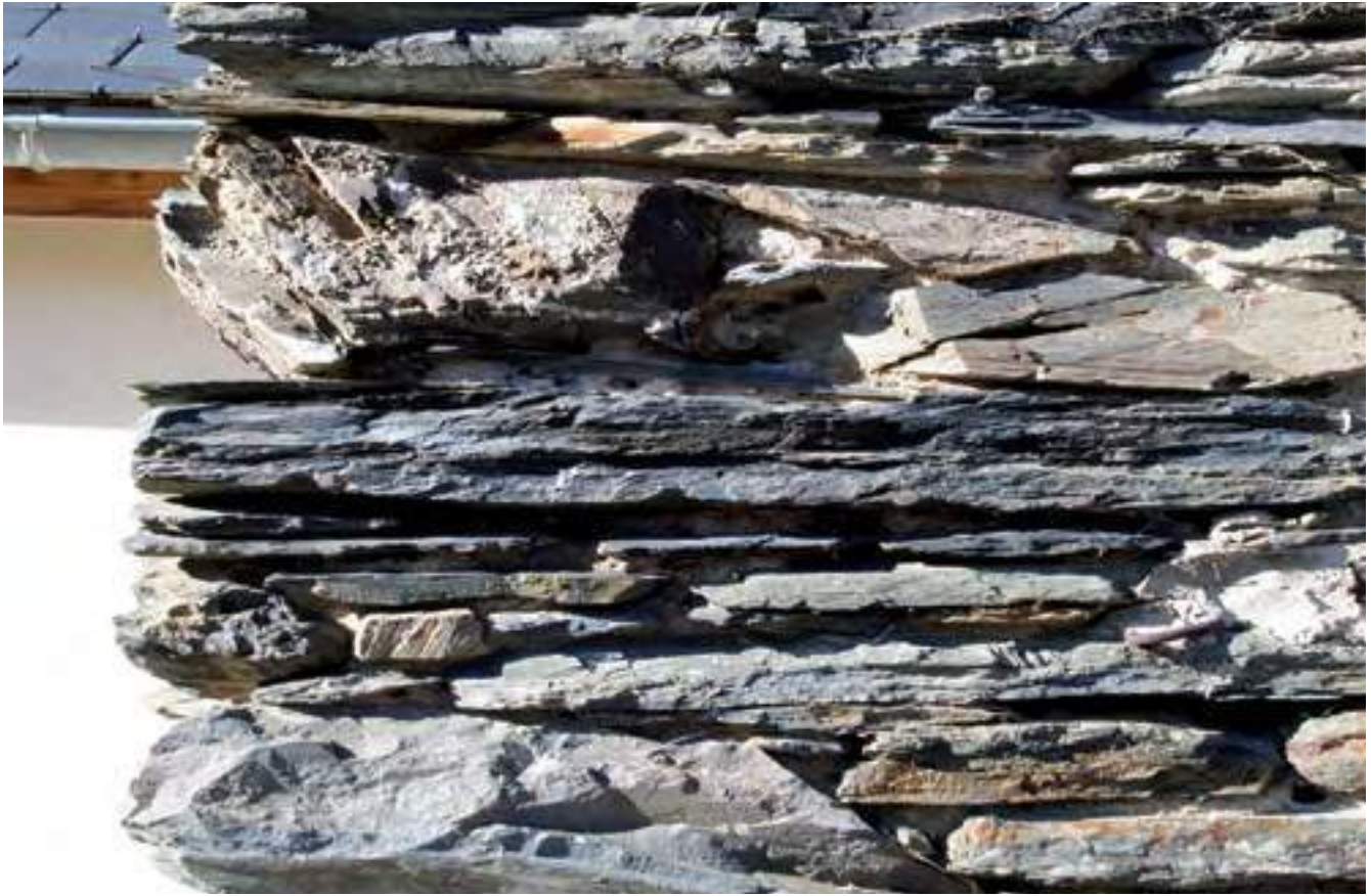
Dalles de schiste appareillées en maçonnerie de pierres sèches dans la vallée d'Ossau. Louvie Soubiron.
